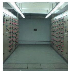
电力监控设备
